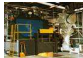
木くずボイラー
