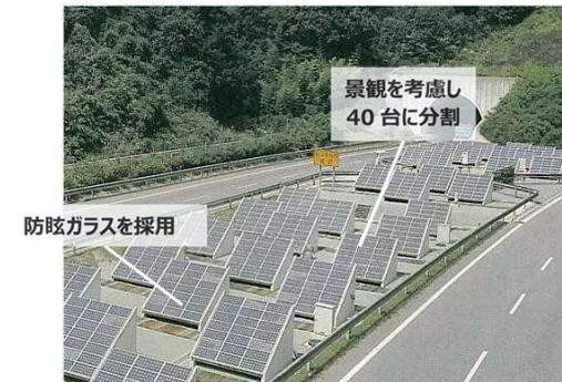
中央帯への設置事例 (北神戸線 長坂山トンネル坑口付近)
