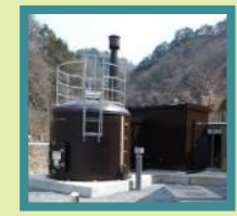
温泉加温ボイラ
